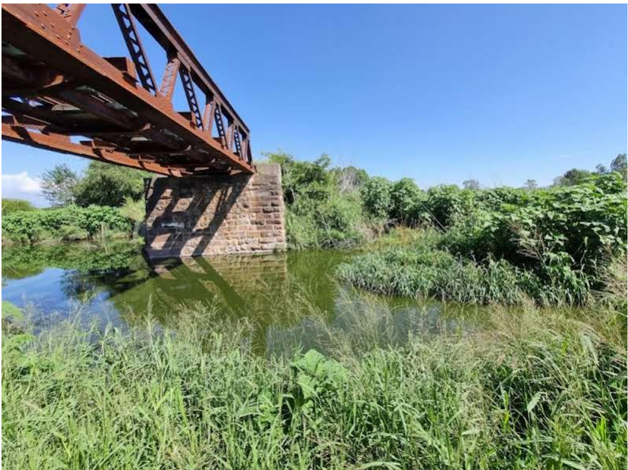
Cabecera norte. Puente ferrocarril sobre río Los Alisos. Acumulación de agua servida. Foto 27/12/2024.
