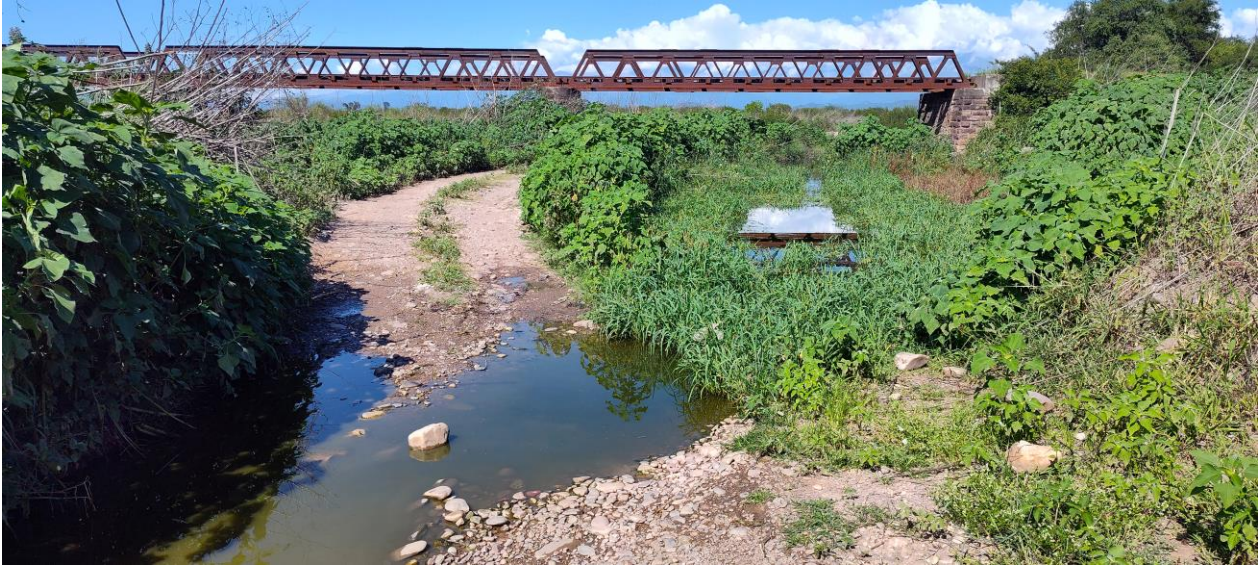
Puente ferrocarril sobre río Los Alisos. Cruce camino. Agua servida cruza el camino yendo a desaguar al río. Foto 27/12/2024.
